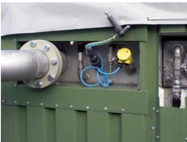
Abb. 2a und b: Mögliche Eisensalz-Dosierstelle in die Substratleitung (oberes Bild) und direkt in den Fermenter (unteres Bild).
